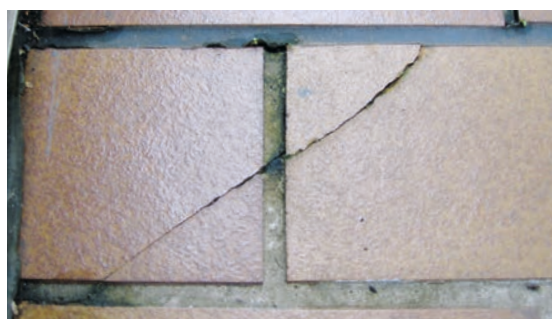
■ Risse und Sprünge
